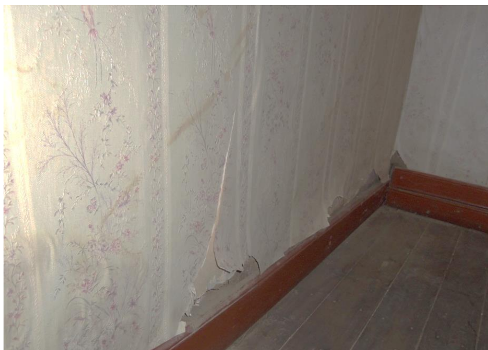
Vista de deformación en muros por inestabilidad estructural del adobe
