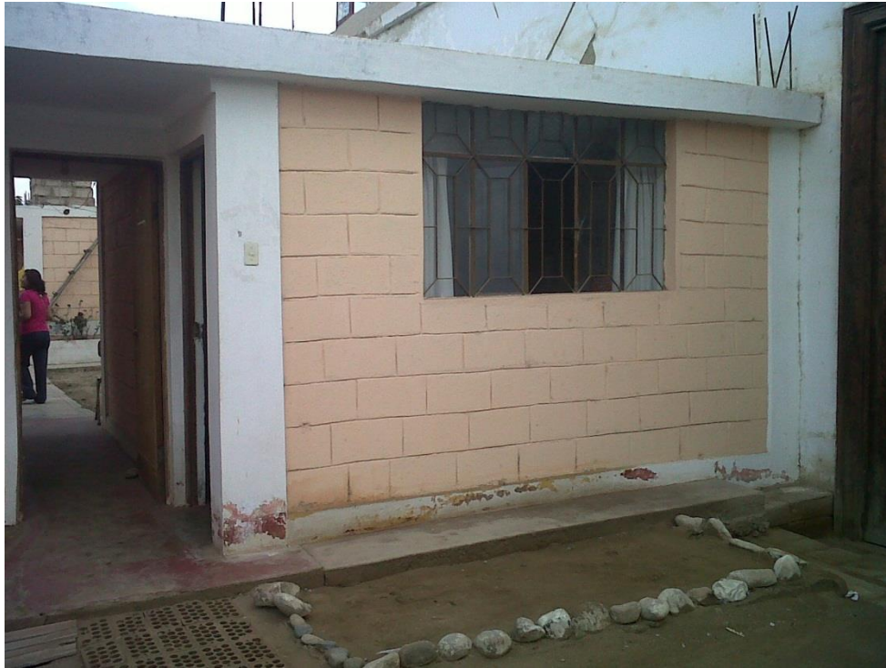
Vista del ingreso a la oficina y vivienda, nótese que la vivienda no tiene junta con respecto al inmueble
