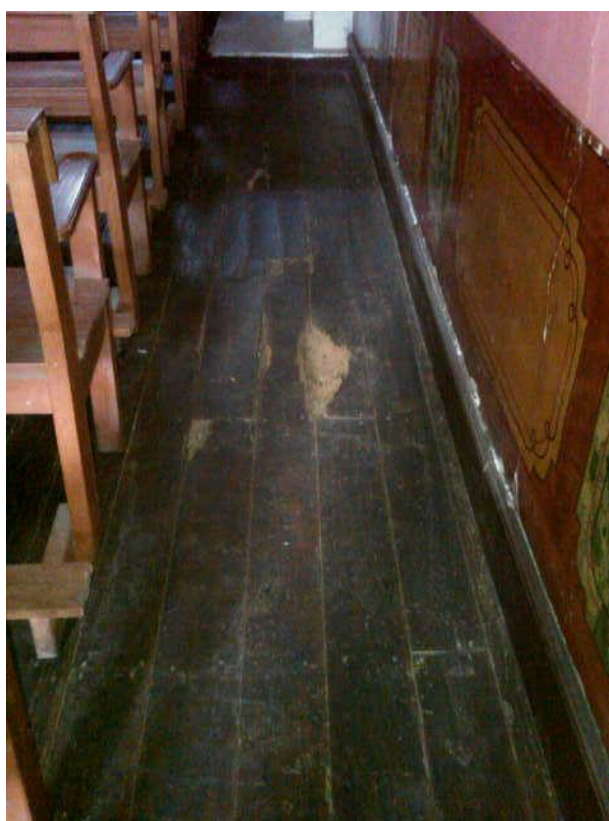
Vista de estado actual del piso de madera entablada afectada por microorganismos. (Nave Central)
