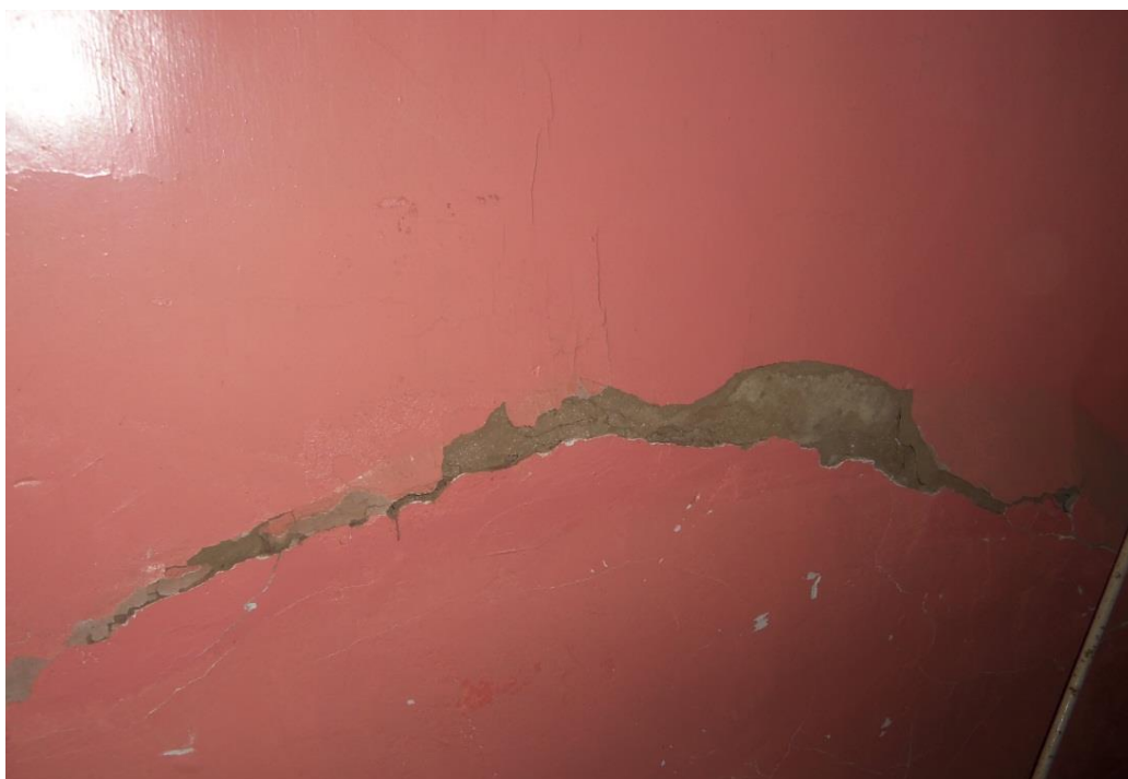
Vista de muros interiores en Altar Mayor, desprendimientos de revestimiento. (Altar Mayor)
