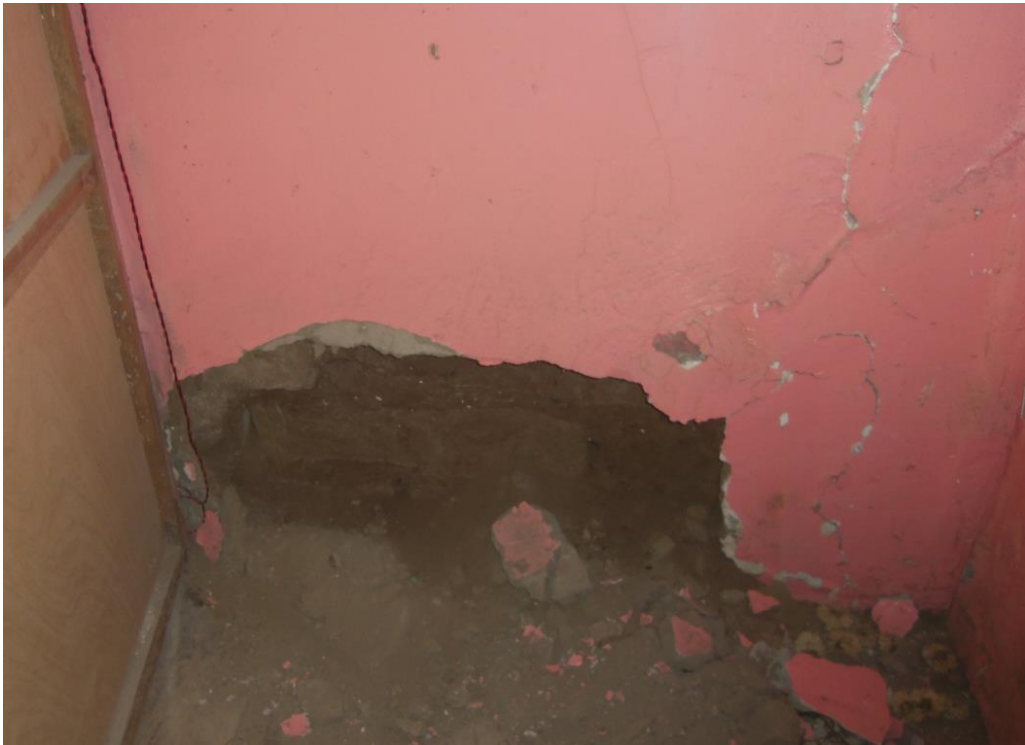
Muros interiores de Altar Mayor, ausencia de bloques de adobe
