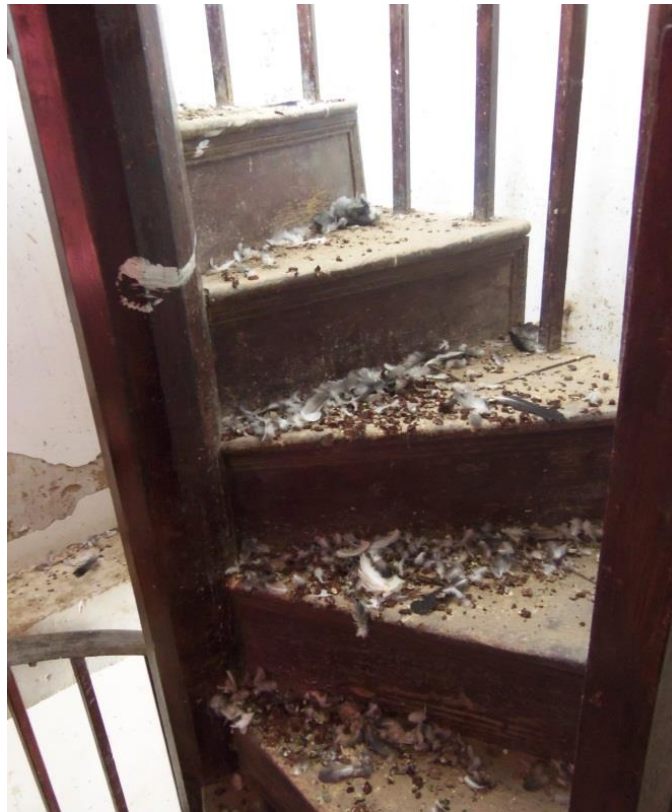
Estado actual de escalera en campanario
