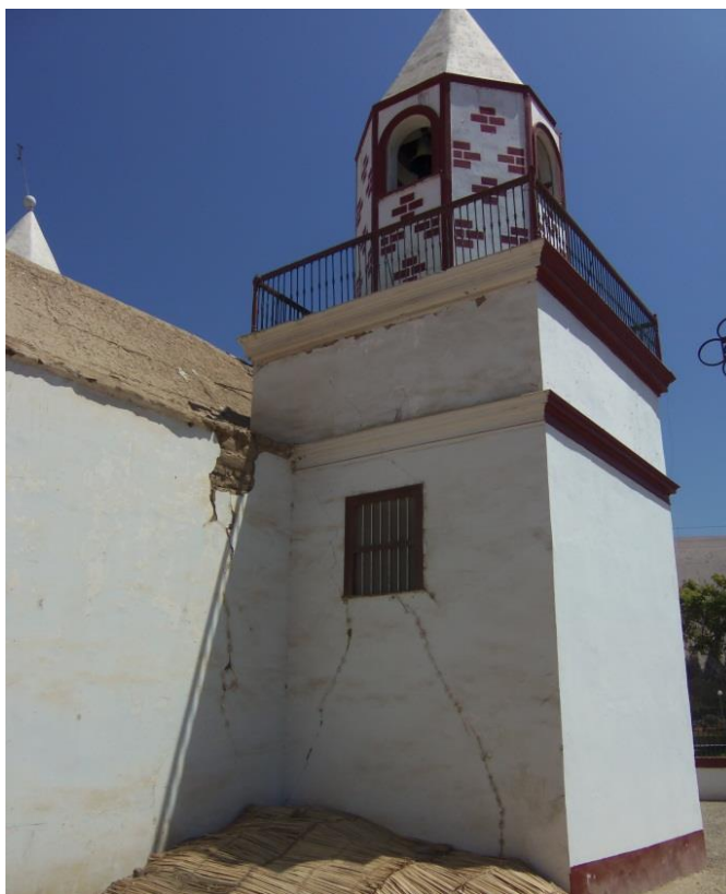
Vista de agrietamientos y desprendimientos exteriores
