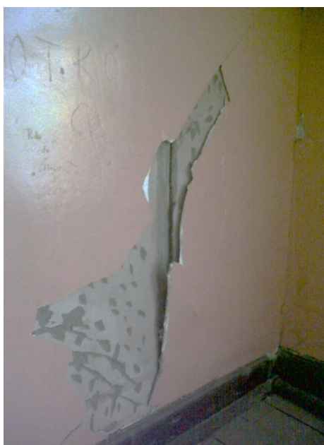
Imagen 40: Vista de la deformación de muros, además desprendimiento de pinturas y revoques.
