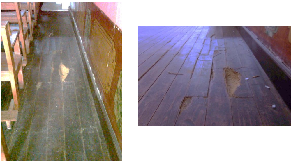
Imagen 25: Vistas de madera carcomida, desgastada y deforme.
