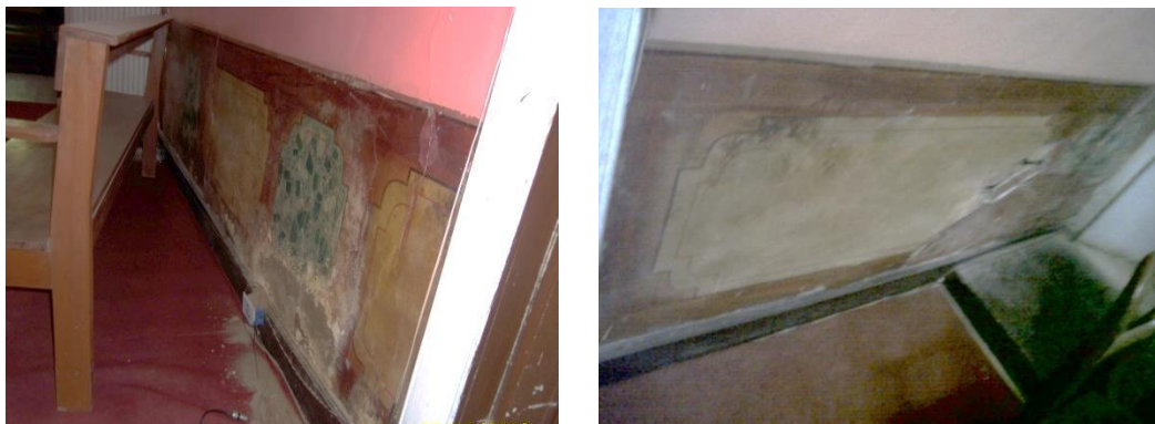
Imagen 22: Vistas de agrietamiento en el zocalo de muros, presentando en algunas zonas serios agrietamientos y hasta desprendimientos.
