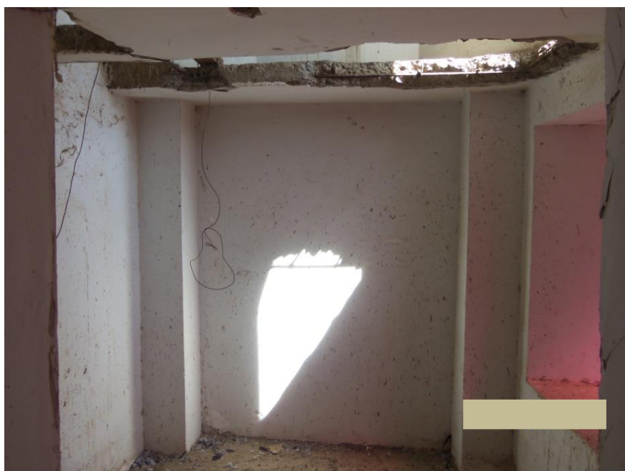
Imagen 43: Vista interior del espacio contiguo al coro, notese el techo destruido y el estado de conservación en el que se encuentra.
