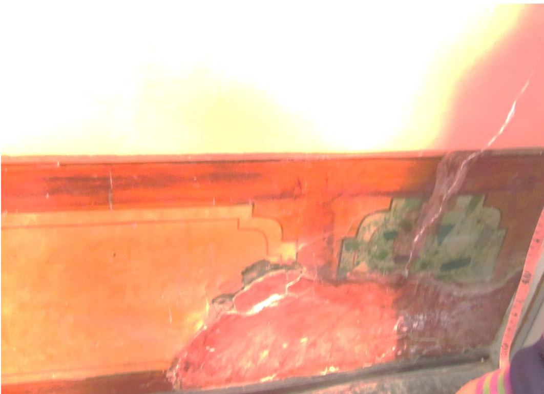
Vista de agrietamiento en mural de zócalo en nave central.
