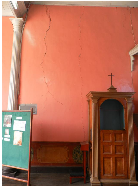
Vista de fisuras en muros interiores
