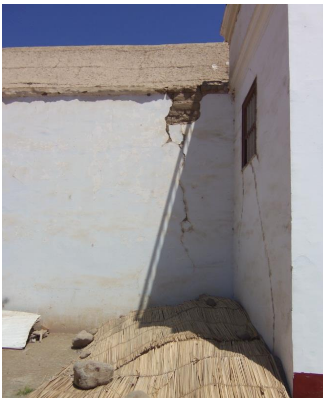
Vista de agrietamientos y desprendimientos exteriores
