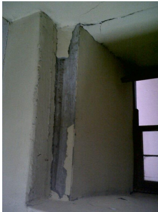
Imagen 62: Vista interior de la Sacristía, notese los agrietamientos en muros y vanos.
