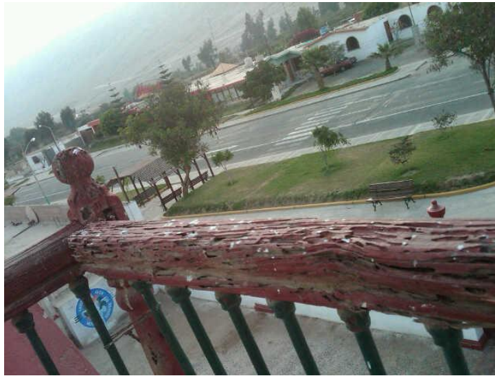
Imagen 10: Nótese en la imagen el estado de las barandas de madera, totalmente carcomidas por microorganismos y sin ningún tipo de mantenimiento.
