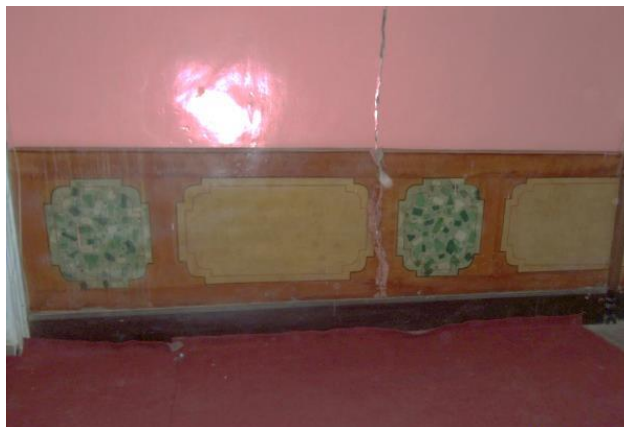
Imagen 21: Vistas de agrietamiento en zocalos.
