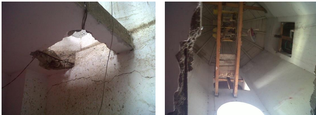
Imagen 42: Vista del interior de los relojes ubicados en torre derecha, y debilitación de la estructura de la losa debido a la perforación que ha sufrido la misma.
