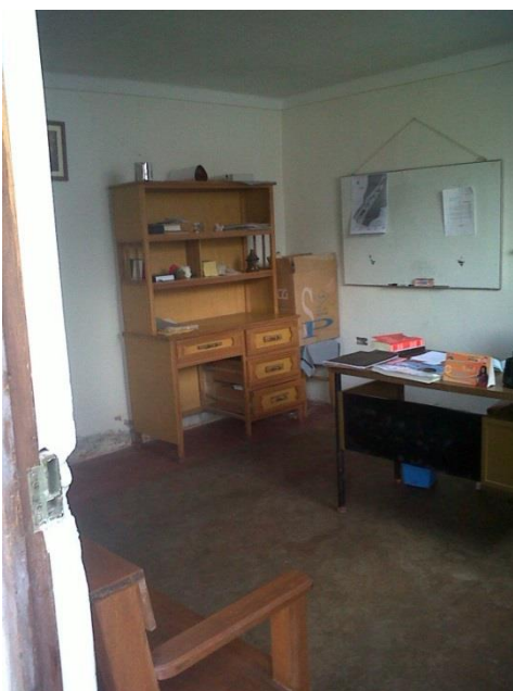
Imagen 55: Vista de la oficina administrativa actual, sin acabados ni una distribución adecuada para la atención al público, ausencia de espacios como recepción, archivo y servicios higiénicos.
