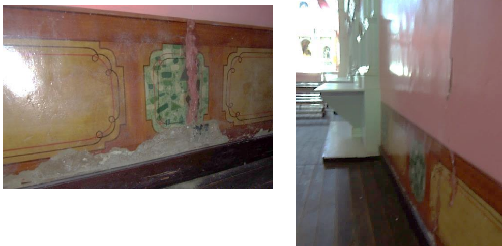
Imagen 26: Vistas de agrietamiento, desgaste, deformación y desprendimientos de muros de adobe.
