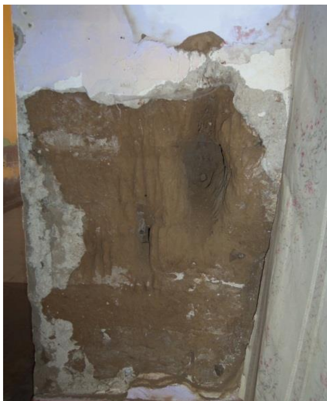
Imagen 52: Vista de afección de humedad en muros de adobe
