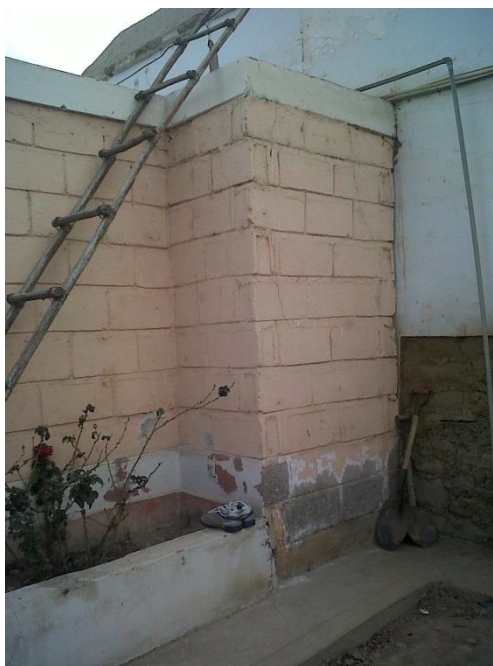
Imagen 60: Vista de la ausencia de separación entre el templo y la vivienda.
