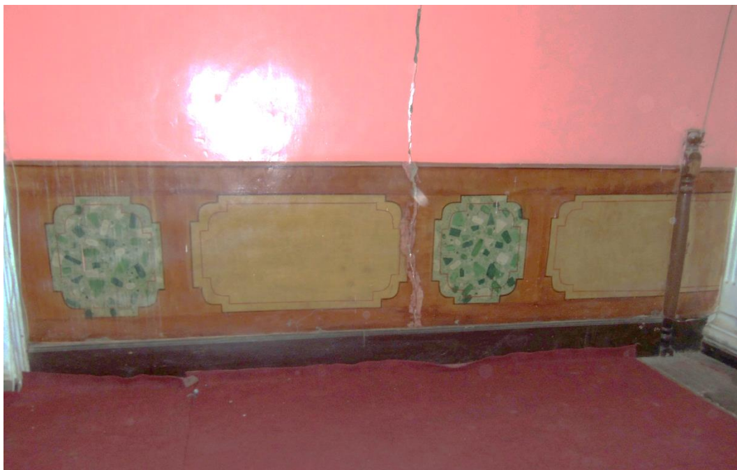
Vista de muros interiores, nótese las fisuras y grietas en muros de Nave Central
