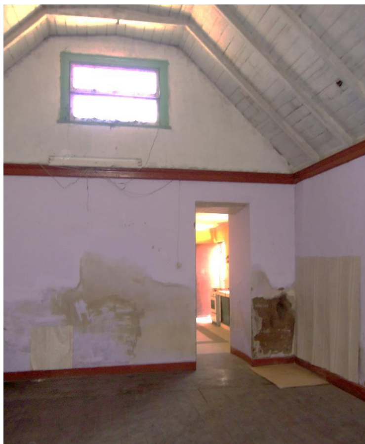
Vista de afección de la humedad en muros
