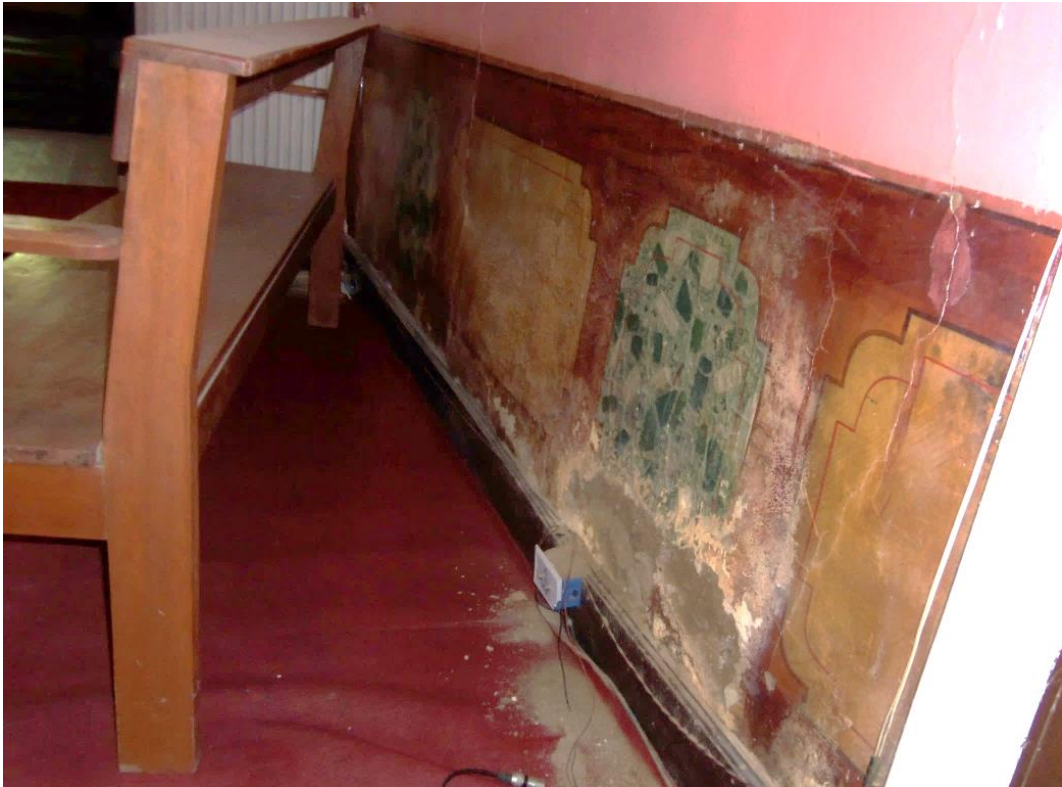
Vista de mural pintado afectado por la humedad
