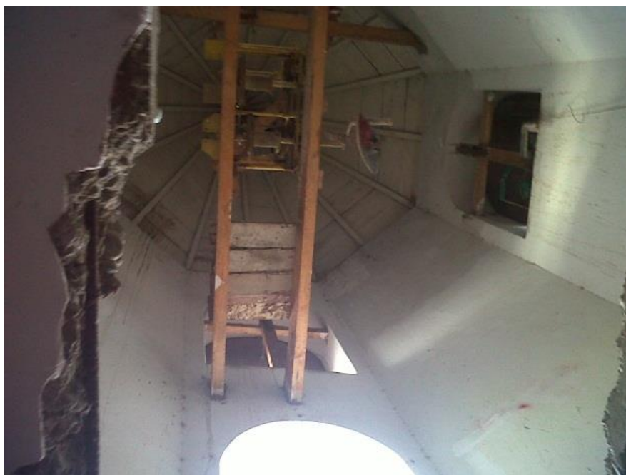
Imagen 44: Vista interior del techo destruido y el sistema de relojes ubicado en lo alto de la torre
