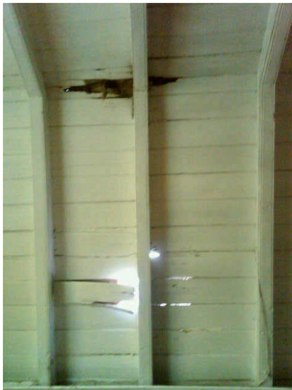
Vista del techo de la iglesia, nótese el desgaste de la madera y la afección de la misma por microorganismos. (Nave Central)
