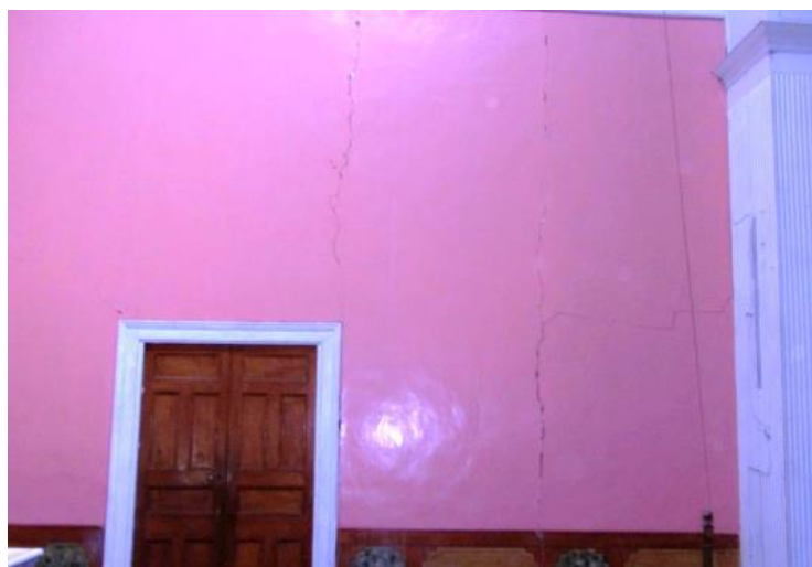
Imagen 23: Vistas de agrietamiento en muros.
