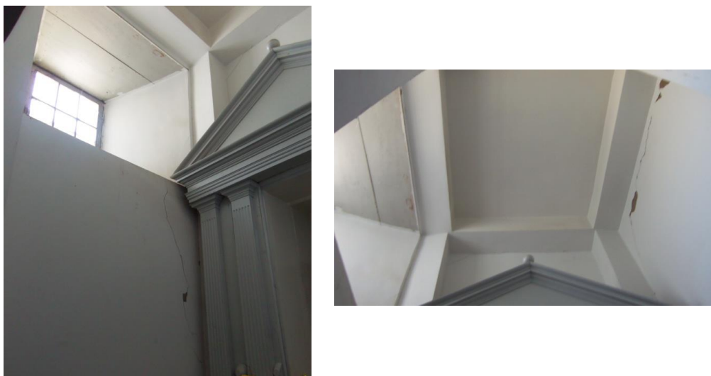
Imagen 38: Vista de agrietamiento en muros, concentrados mayormente en las zonas de vigas y ventana.
