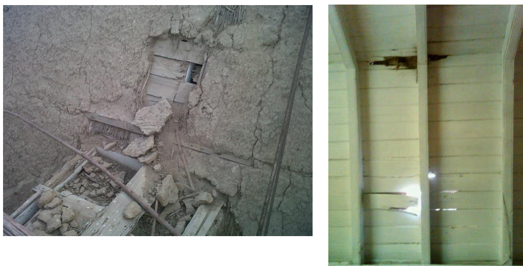
Imagen 47: Vistas de daños en techo exteriormente e interiormente.
