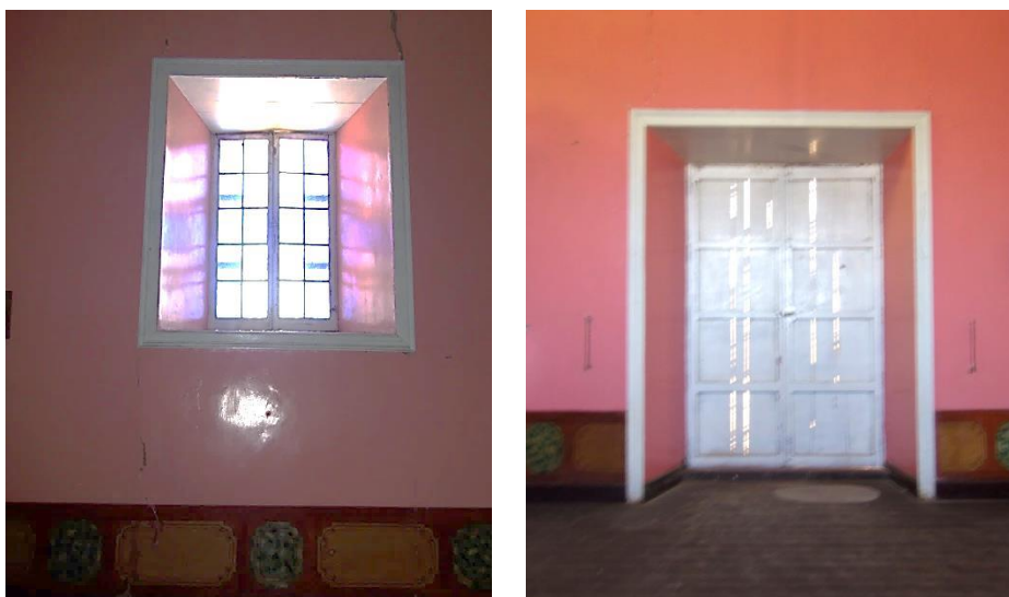
Imagen 27: Vistas vanos ubicados en ambos muros de la Nave, notese el agrietamiento en las paredes.
