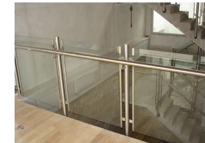
FOTO: Baranda y Vidrio de 10mm
