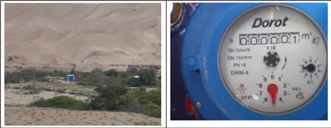
Imagen N° 06 y 07 :En las imágenes se muestra el Pozo N°03 Se encuentra ubicado en la parte media del valle del cinto a 400 metros aguas abajo del pozo N° 02 y frente al poblado de cinto, con coordenadas UTM 8064067N y 317691E
