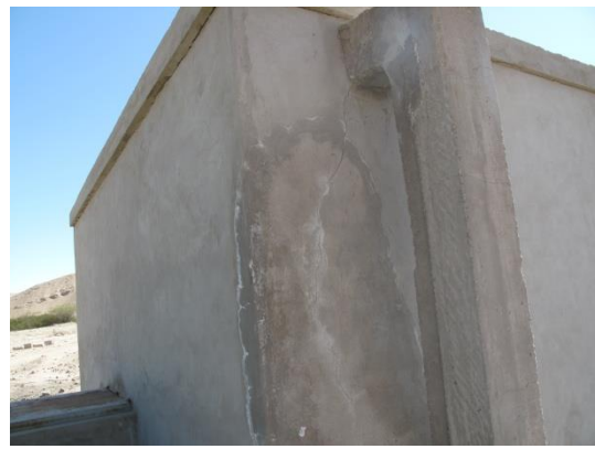
Imagen N° 17: El reservorio se encuentra agrietado, lo cual ocasiona la filtración del agua.
