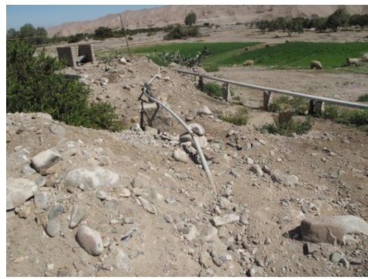
Imagen N° 09: En el lote rural N° 013670 del valle de Cinto se muestra la tubería de conducción de PVC 2", la cual está expuesta a la intemperie.
