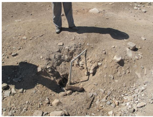
Imagen N° 08: La imagen muestra la tubería de conexión domiciliar expuesta, ubicada a 325 m antes de llegar al poblado de Matogroso.
