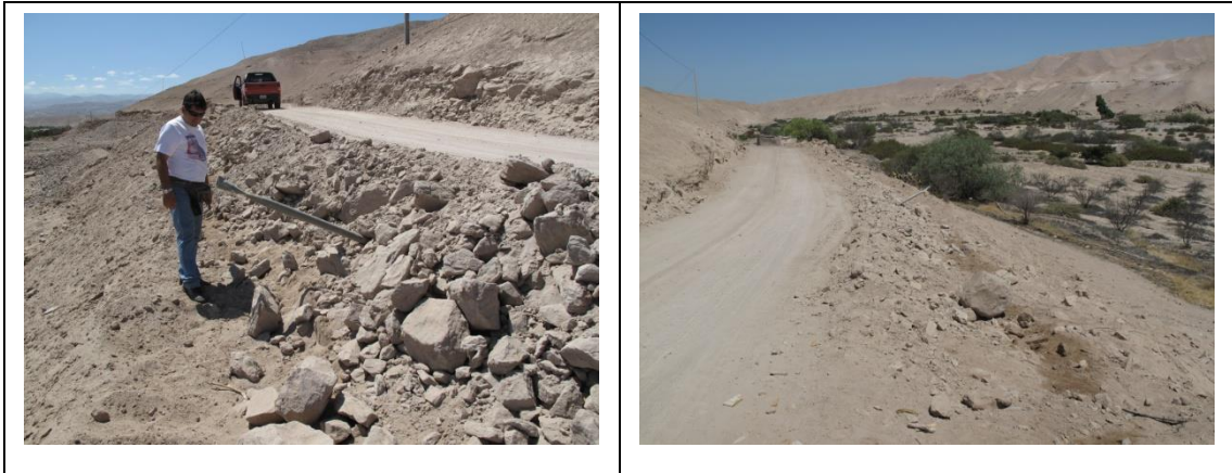
Imagen N° 12 y 13: En las imágenes se puede observar la línea de conducción existente entre el poblado de Cinto - Chironta se encuentra dañado, producto de trabajos con maquinaria pesada.
