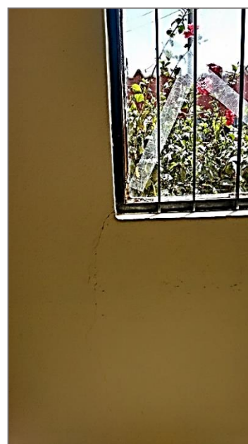
Se observa grietas, debido a la ausencia de junta de dilatación en el encuentro muro portante – alféizar (elemento estructural - elemento no estructural).
