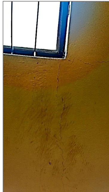
Se observa grietas, debido a la ausencia de junta de dilatación en el encuentro muro portante – alféizar (elemento estructural - elemento no estructural).
