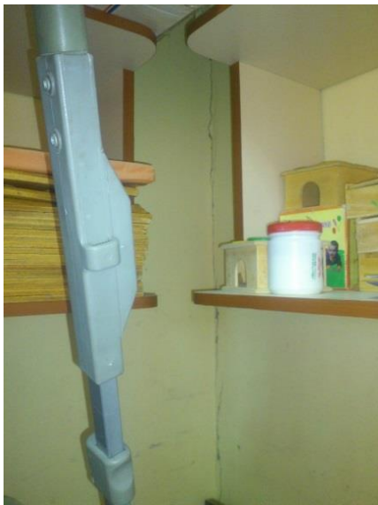
Presencia de grietas en los encuentros de muros y columna, esto se ha ocasionado por ausencia de juntas dilatación.
